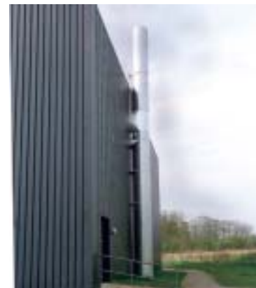
Kedelhallen på Trustrup-Lyngby Varmeværk forsynes med ren luft fra et 80 cm rør, der har indtag 3 meter over kedelhallens tag.
