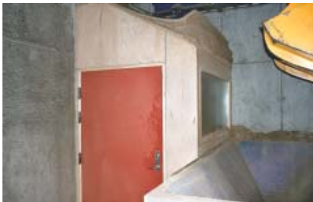
På Trustrup-Lyngby Varmeværk er slusen bygget på lagersiden af branddøren. Slusen er forsynet med inspektionsrude, så de fleste lagerbesøg ikke går længere end til slusen. Bemærk, at loftet i slusen er skråt, så smuld glider ned af sig selv.
